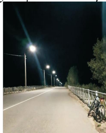
Изготовление ФКУ ЛИУ-4 уличных светодиодных светильников для нужд КУ РК «Управление Автомобильных дорог Республики Карелия»
